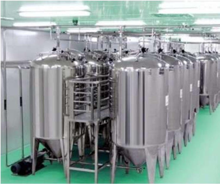
Cuve de Stockage
