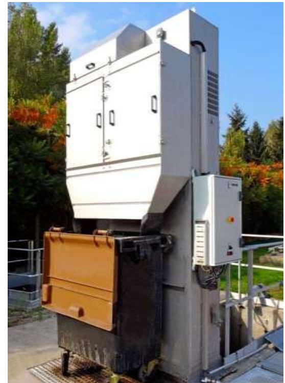
DEGRILLEUR VERTICAL A CABLES
